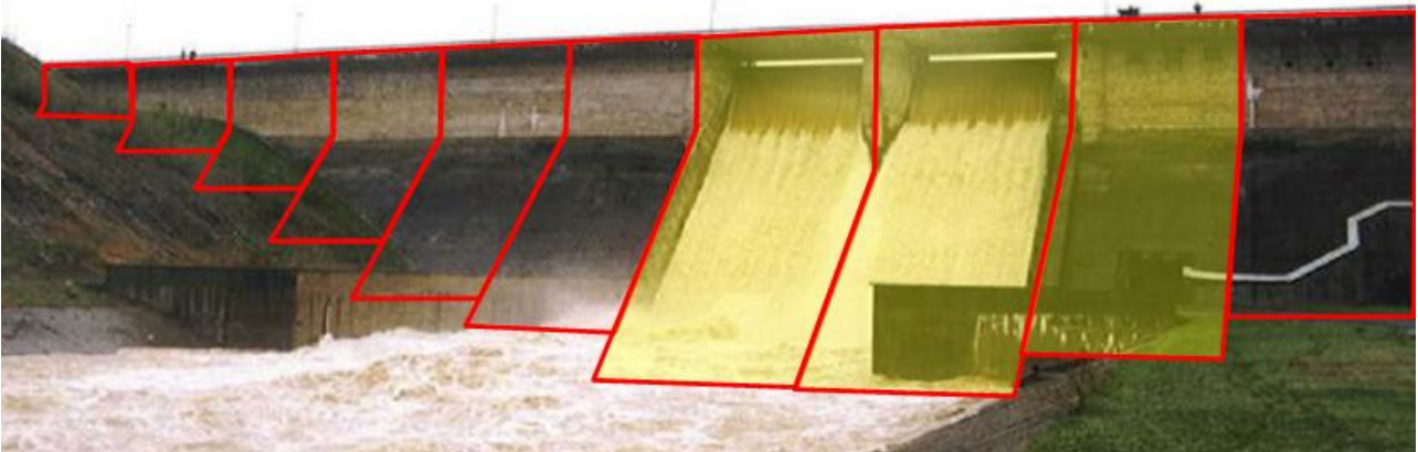
III. 7. Beispielhafte Lokalisationen von beschädigten Sektionen des Korpus des Betondamms infolge des Verlusts der Untergrundstabilität (Besko)
